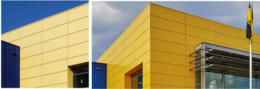
Abbildung 2: Auf der linken Seite ist eine Standard-Pulverbeschichtung nach nur 5 Jahren zu sehen und auf der rechten Seite eine Duraflon-Beschichtung nach 11 Jahren. Das Gebäude steht hier in Süddeutschland.
